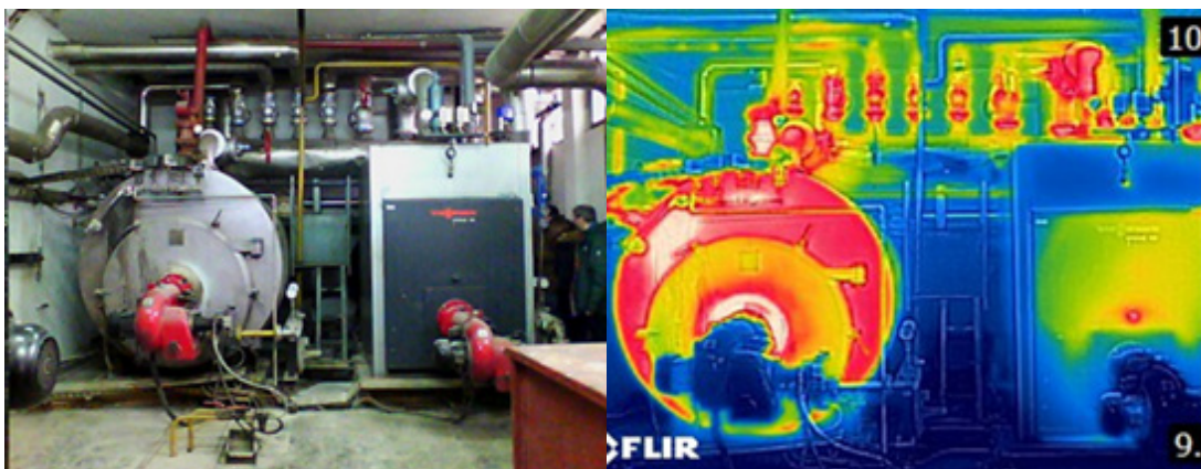
Slika 23. Gubici toplote kroz oplatu kotlova, oštećena izolacija kotlova i parovoda (arhiva autora)
