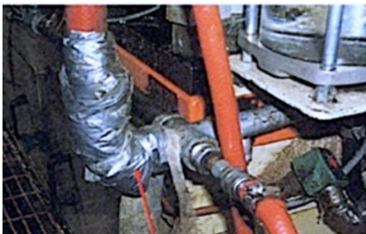
Slika 35. Oštećenost distributivne mreže komprimiranog zraka (pojava curenja)
