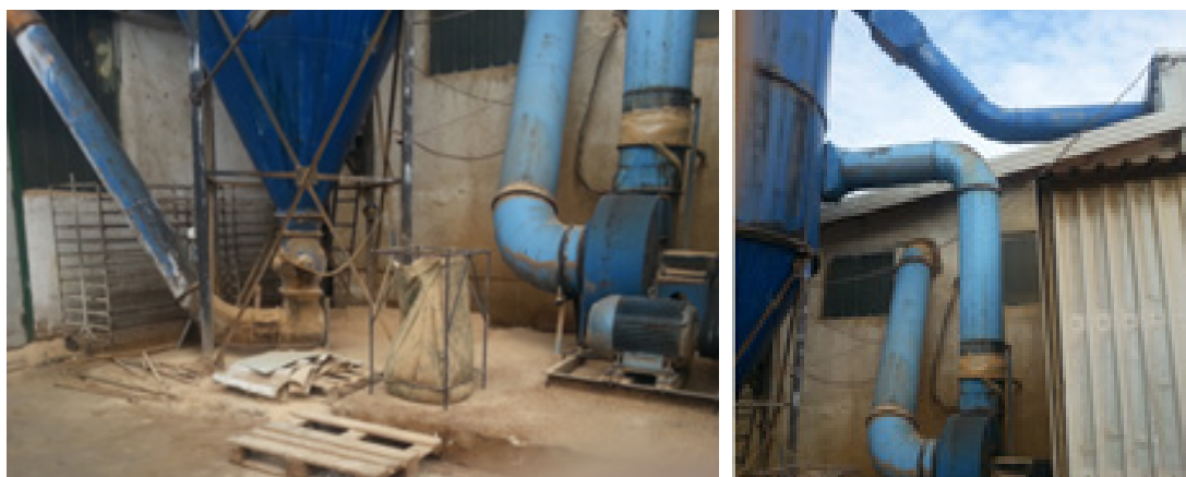
Slika 12. Nepravilno izvedeni spojevi na ventilatoru i odvajaču (arhiva autora)
