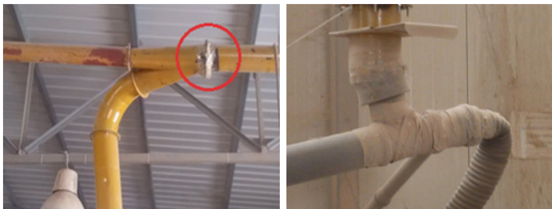
Slika 11. Nepravilno izvedeni spojevi cijevne mreže lijepljeni trakom (arhiva autora)
