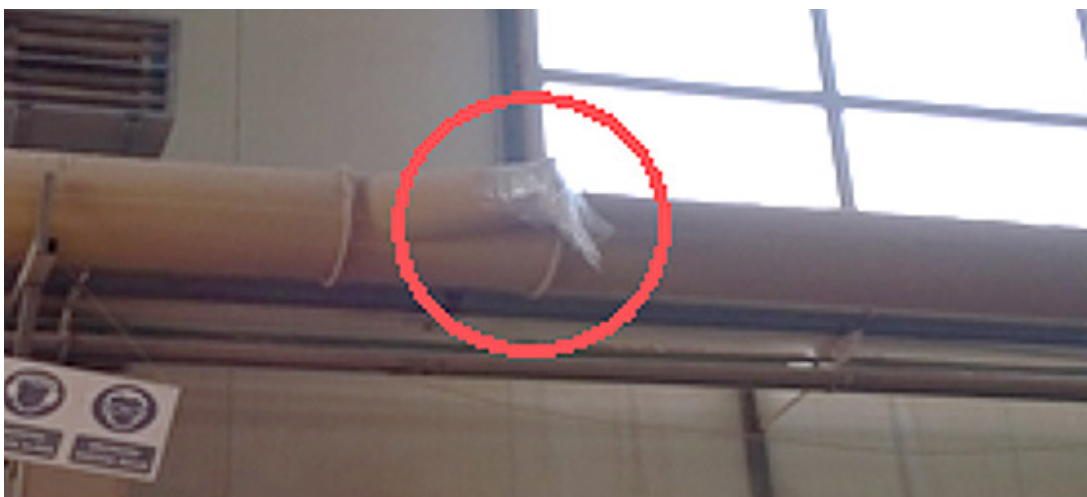
Slika 13. Oštećenje cijevne mreže u difuznom grlu (arhiva autora)
